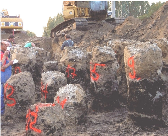
Bild 8: Freigelegte TVSS unterschiedlicher Ausbildung
